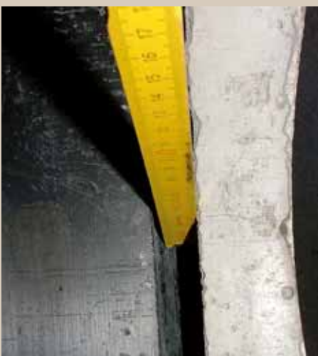
Verformungen am Plasson Schachtanschluss, Blick auf den Scheitel des Anschlusses
